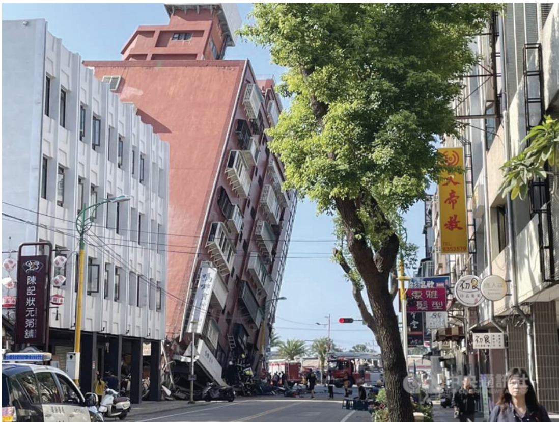
花莲3日发生7.2级地震，造成一栋位于中山路重庆路口的房屋倾斜，有民众被困在内。
